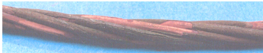
(d) Heavy Visual Damage – Moderate/Heavy Flaking of Outer Corrosion Layers
